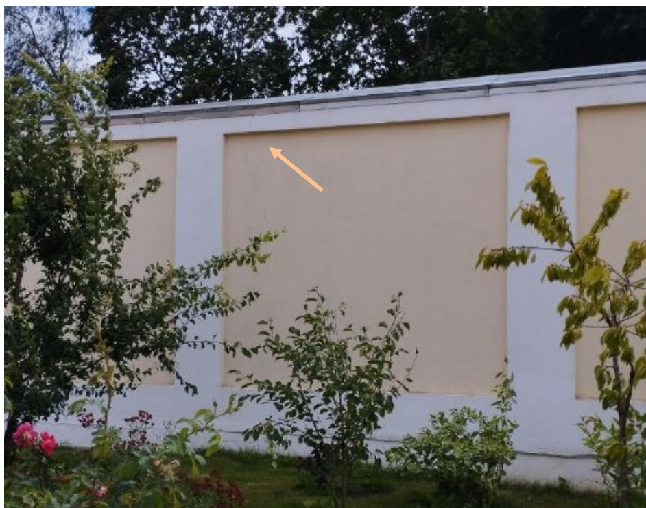
Рисунок 2. Южная часть забора Никитского монастыря, 3-я секция от главного входа (внутренняя сторона)
