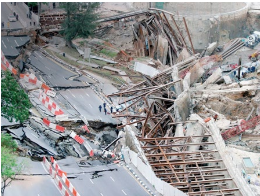
Разрушение тоннеля Никол Хайвэй (Сингапур), 2004 г.
